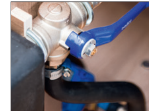
Direktavlopp: förbikoppling grävattentank
