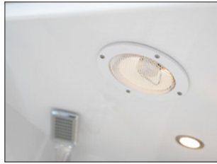
Fläkt i duschkabin (TDL, 780 DGLE)
