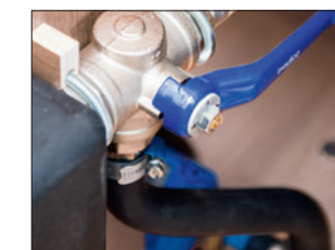
Direktavlopp: förbikoppling grävattentank
