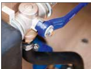
Direktavlopp; förbikoppling gråvattentank
