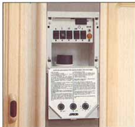
Centralvärmepannan har en lätt åtkomlig kontrollpanel i bekväm arbetshöjd
