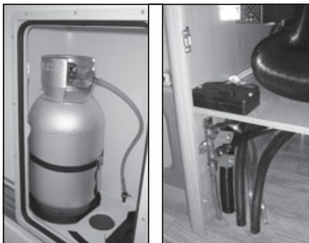
Huvudkran på gasolflaskan och gasolventil till pannan.
