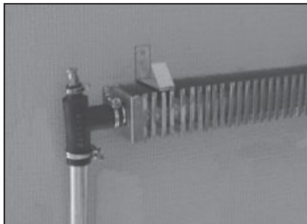
Konvektor och slanganslutning med luftningsnippl.
