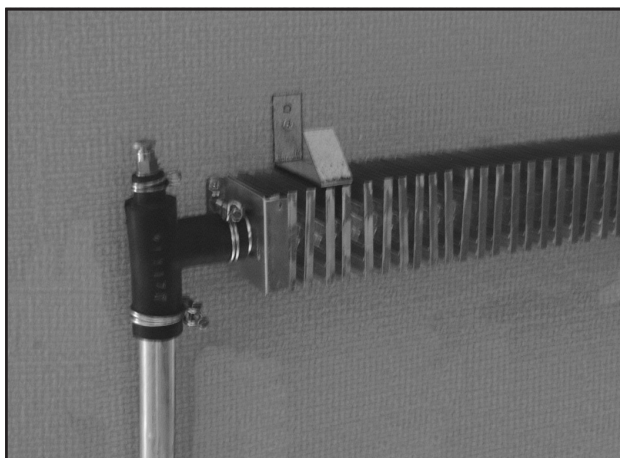
Konvektor och slanganslutning med luftningsnippel.
