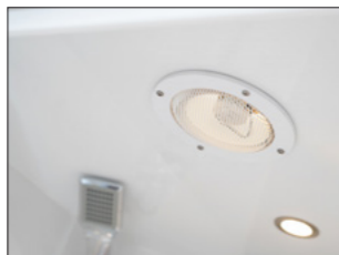
Fläkt i duschkabin (TDL)
