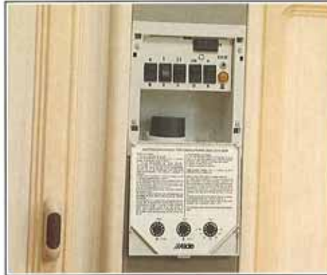
Centralvärmepannan har en lätt åtkomlig kontrollpanel i bekväm arbetshöjd.
