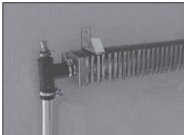
Konvektor och slanganslutning med luftningsnippl.
