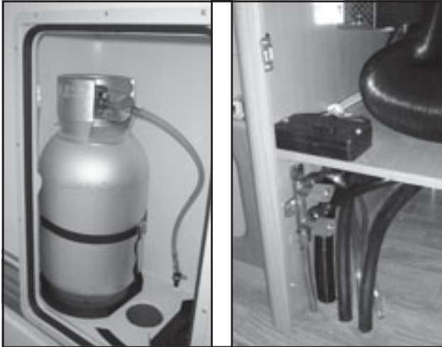
Huvudkran på gasolflaskan och gasolventil till pannan.
