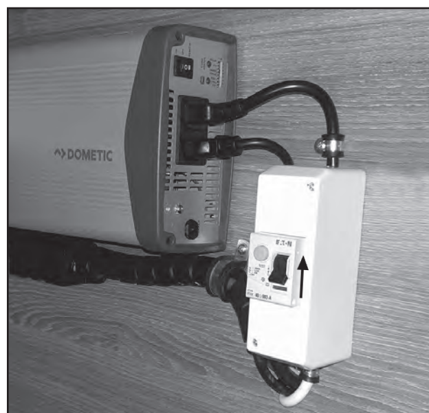
En jordfelsbrytare är monterad vid Inverters.
