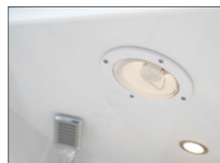
Fläkt i duschkabin (TDL)
