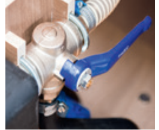
Direktavlopp; förbikoppling gråvattentank
