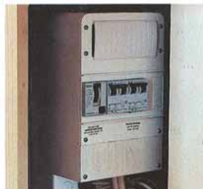
Elcentral med jordfelsbrytare
