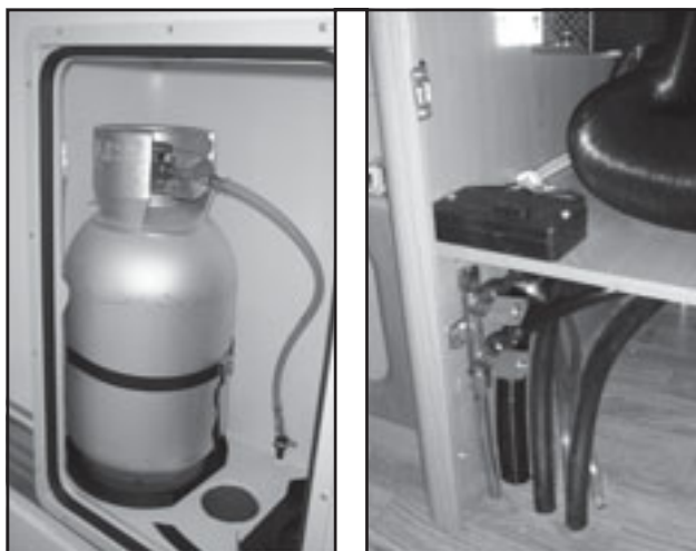
Huvudkran på gasolflaskan och gasolventil till pannan.
