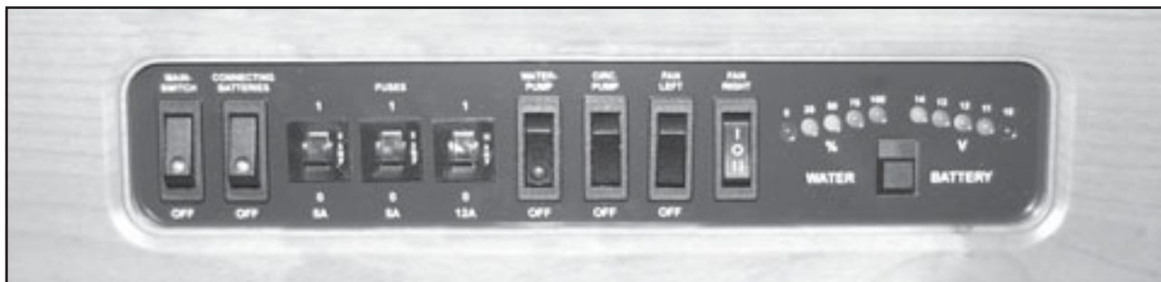
Manöverpanel, stora panelen.
