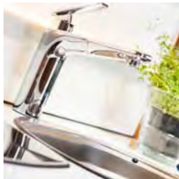
Rundad diskho och smäcker utanpåliggande vattenkran.
