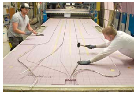
En av Astrids första arbetsuppgifter har blivit att fräsa ut spåren för de fyra golvvärmeledningarna i isoleringsmaterialet.
